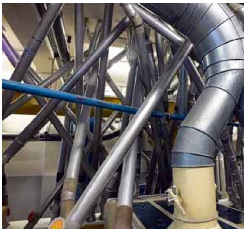
Die unterschiedlichen Produkte aus der Mühle werden durch ein vermeintliches Wirrwarr an Rohren sortiert.
