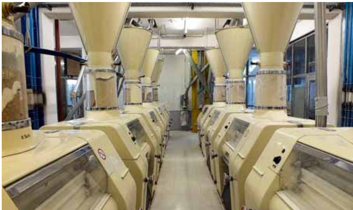
Voll automatisiert ist das Herz der Mühle mit ihren „Walzenstühlen“.
